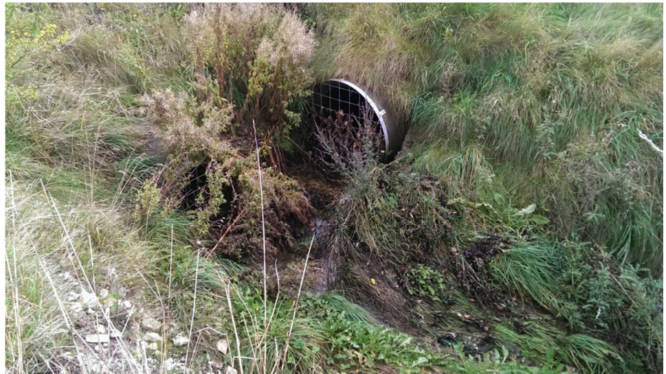
Figur 2-14 Regnvandsudløb (2 stk.) fra østsiden af projektområdet
