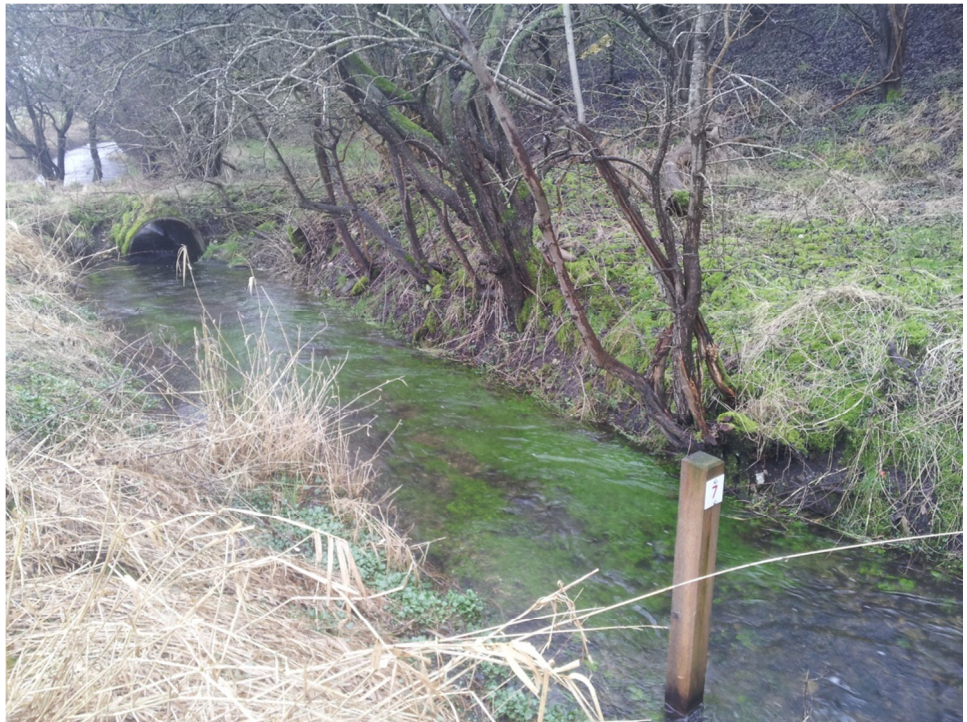
Figur 2-9 Skalapæl og rørlagt overkørsel ved Bækken st. ca. 2450
